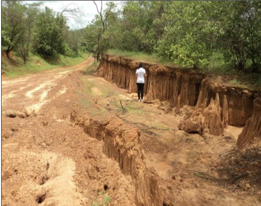
Figura 32 - Erosão hipodérmica ( piping ) e processo de ravinamento - Argissolo Vermelho-Amarelo próximo a estrada de acesso à cidade/município de Lagoa do Sítio
