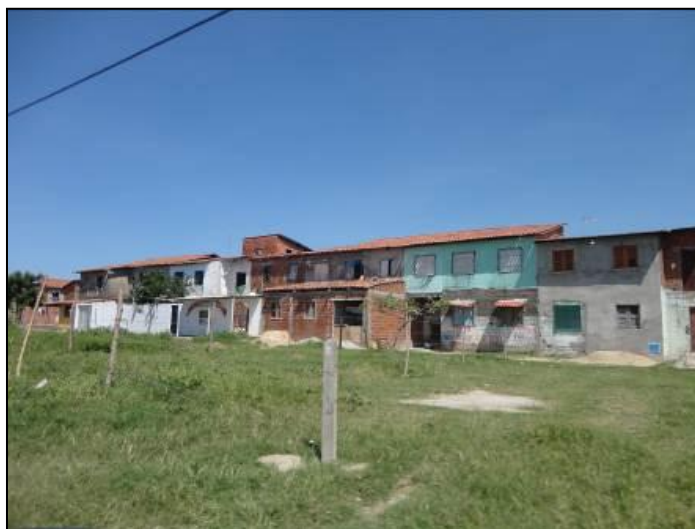
Imagem 11 - Conjunto habitacional com construção inacabada Patativa do Assaré, bairro Jangurussu, Fortaleza – 2012
