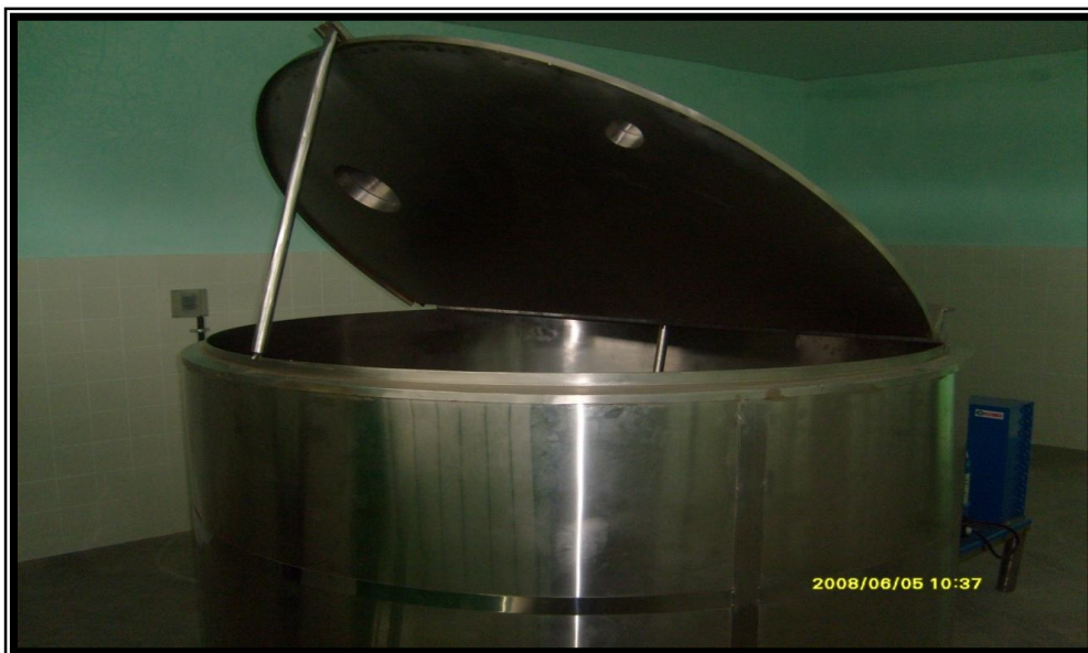
FIGURA 10: Tanque na Unidade de resfriamento de Leite em Madalena. Fonte: Pinto, 2008.
