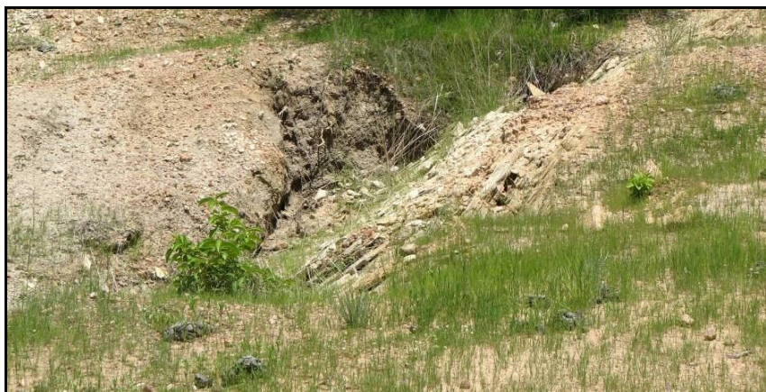
Figura 25 – Erosão em formas de sulcos (março / 2007)
