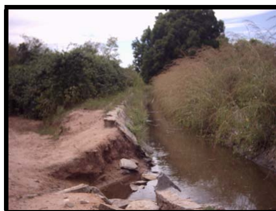
Figura 27: Canal arrombado. O uso indevido, pelas pessoas do próprio perímetro, contribui para a deterioração da infra-estrutura e contaminação da água.
