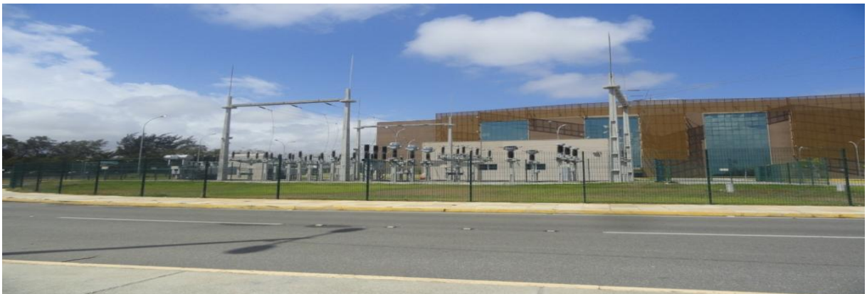
Figura 13 – Subestação da CHESF no Centro de Eventos do Ceará
