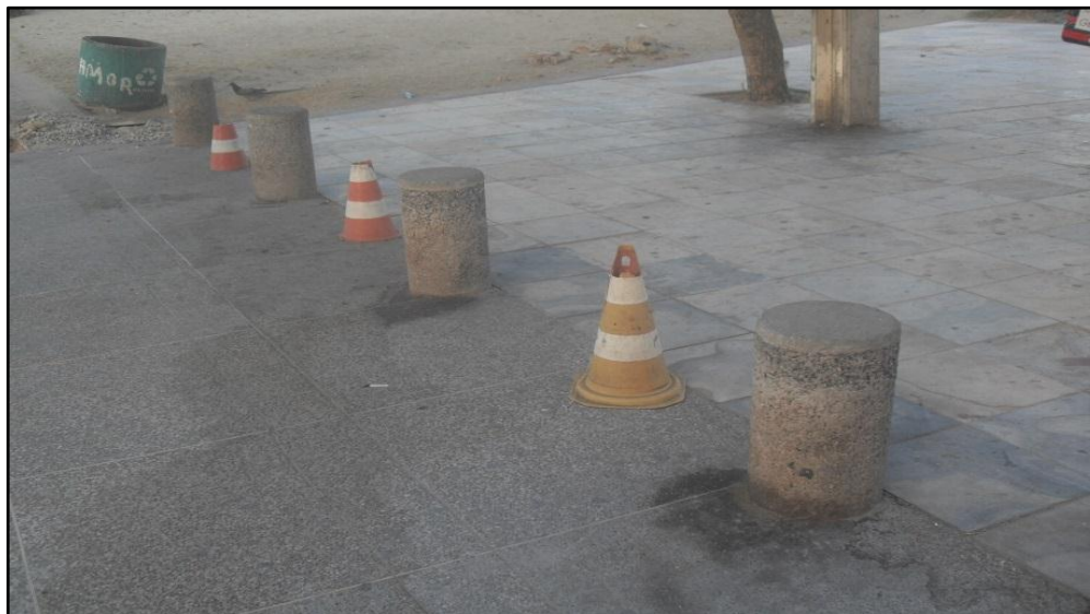
Figura 25 – Obstáculos no calçada
