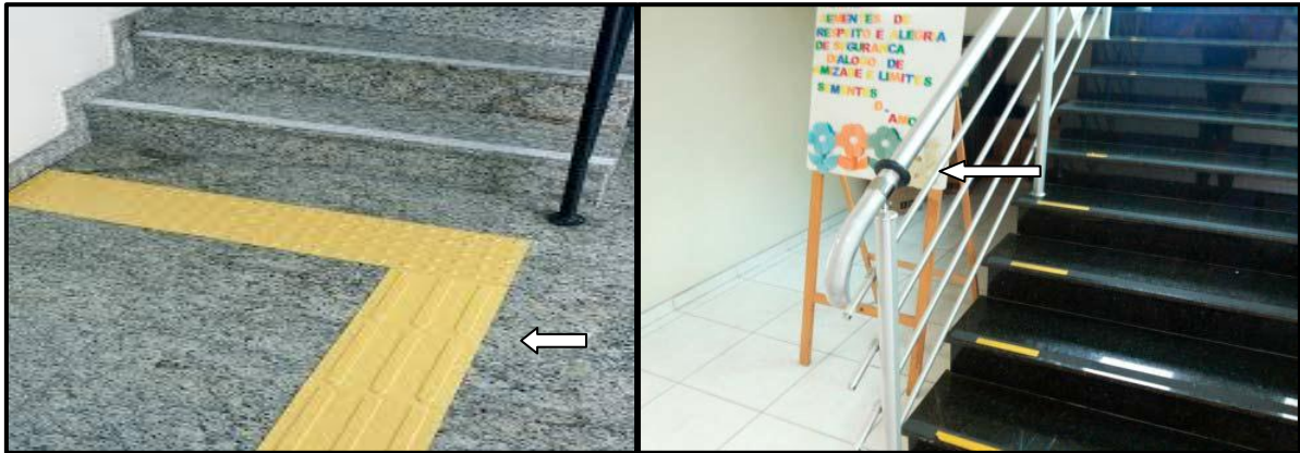
Figura 17 – Exemplo de piso podotátil e anel no corrimão
