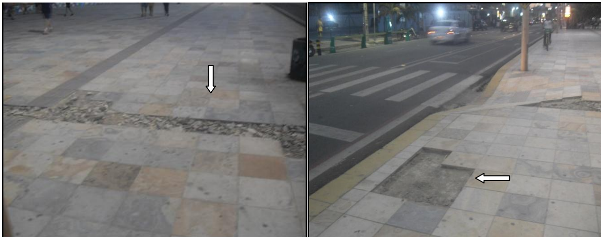
Figura 23 – Piso do calçadão com problemas estruturais
