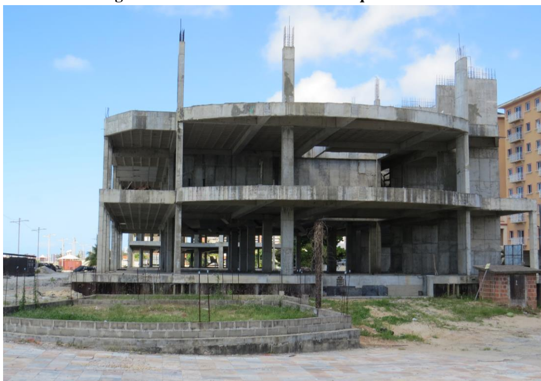
Figura 85 – Obras inacabadas do Acquário Ceará
