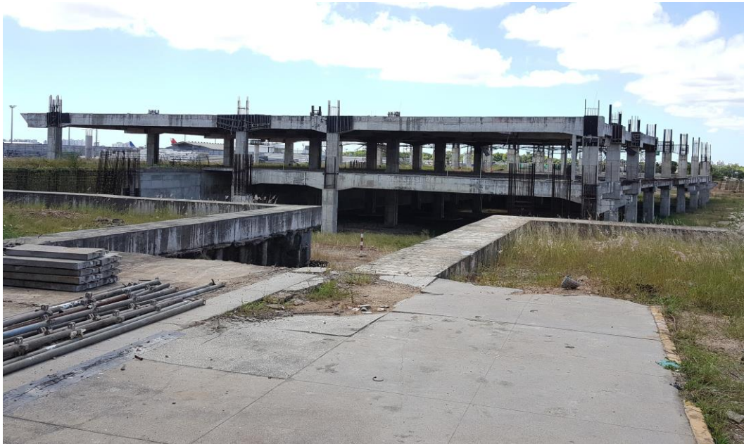
Figura 14 – Estruturas do Aeroporto em processo de deterioração
