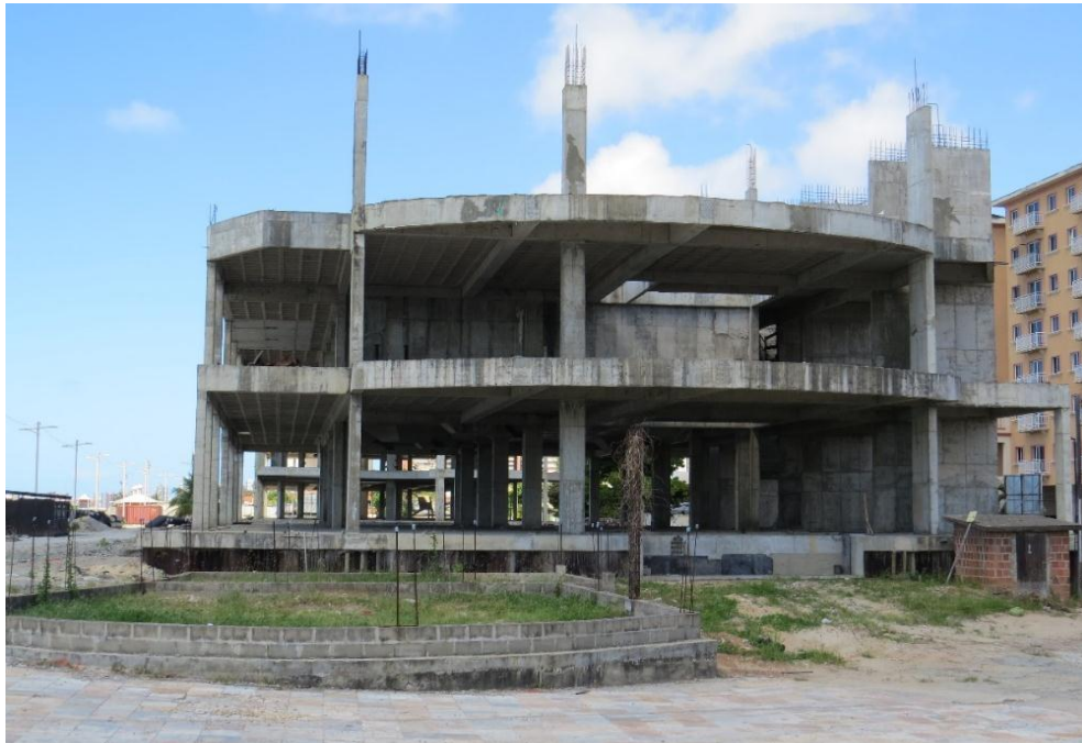
Figura 3 – Obras inacabadas do Acquário Ceará
