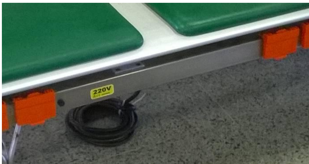
Figura 24 – HI-FI e tomadas
