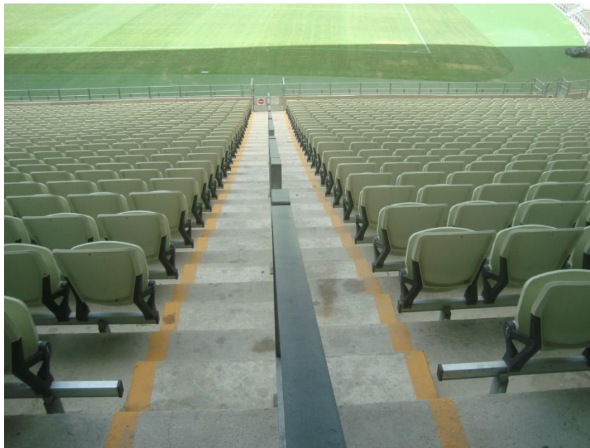
Figura 41 – Foto do corrimão da Arena Castelão Fonte: pesquisa de campo, 2013. Fotógrafo: Ícaro C. Honório.
